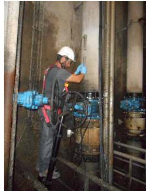
Opération de contrôle d'un débitmètre
